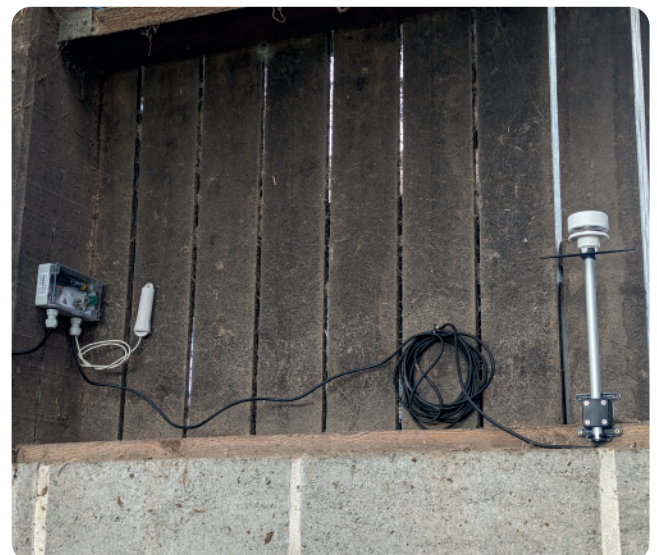
Mesure des flux d'air dans un bâtiment avec un anémomètre à ultrasons et un émetteur 0-10V
