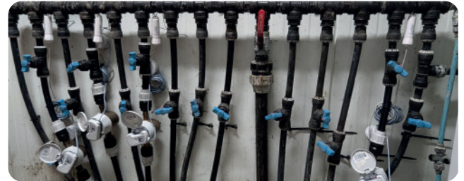
Suivi de la consommation d'eau et détection de fuites avec un compteur d'impulsions
